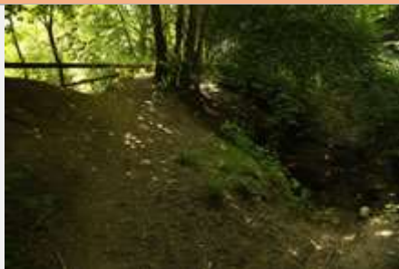
Altra immagine del punto in cui il fiume Olona ha eroso il sedime ferroviario, tra Gurone e Malnate Olona (M. Viganò, 2015)
