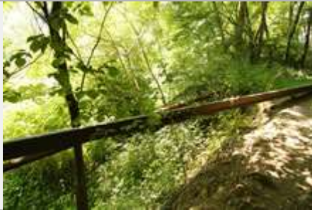
Vecchio binario sospeso nel vuoto sul fiume Olona, che ha eroso il sedime ferroviario (M. Viganò, 2015)
