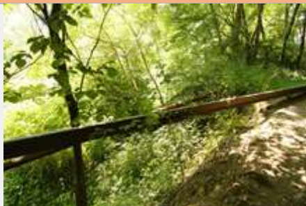
Vecchio binario sospeso nel vuoto sul fiume Olona, che ha eroso il sedime ferroviario (M. Viganò, 2015)
