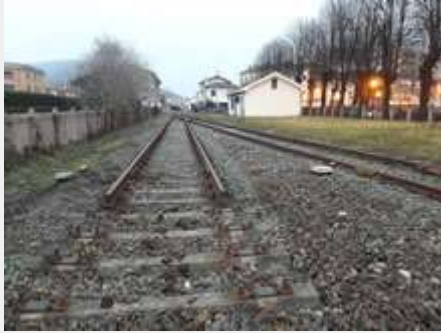
Scambio in uscita dalla stazione di Gattinara, in direzione Arona (Damiano, 2018)
