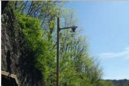
Apparato SSC lungo la linea ingresso della galleria di Campagnola, in direzione Arona (C. Sora, 2014)
