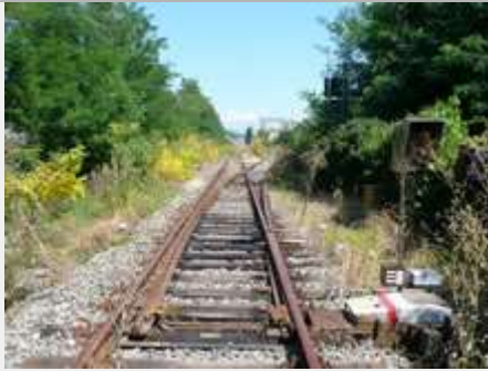
Deviatoio per l'ingresso al binario 1 della stazione di Gattinara, con evidenti segni di ossidazione dell'armamento dovuti all'inutilizzo (F. Gianella, 2013)
