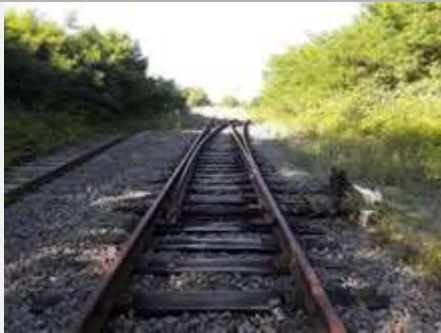
Deviatoio per l'accesso allo scalo merci della stazione di Rovasenda Alta ad azionamento manuale (Damiano, 2017)
