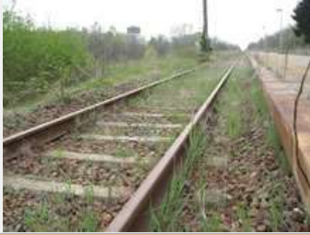
Binario arrugginito alla stazione di Rovasenda Alta (Alessandro, 2013)
