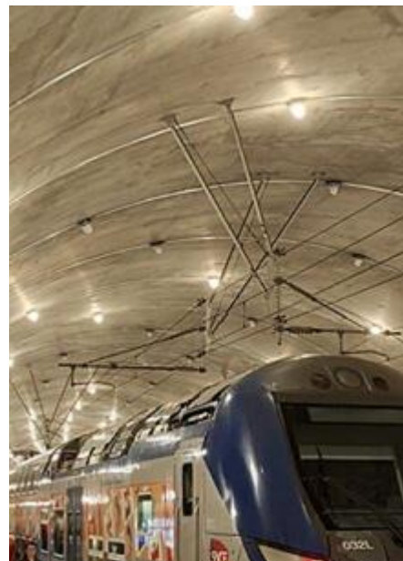
Particolare tralicci sospensione catenaria fissati sulla volta
