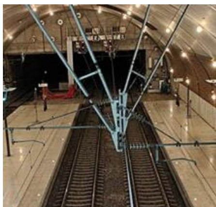
Particolare isolatori e tiranti poligonazione catenaria linea aerea
